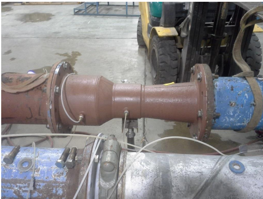
Fig. 12. Halmi Venturi meter installation.
