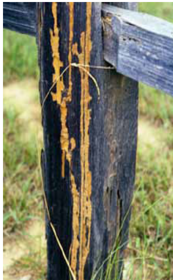
Fig. 7. Poste con tubos de lodo de termitas subterráneas del este. 6
