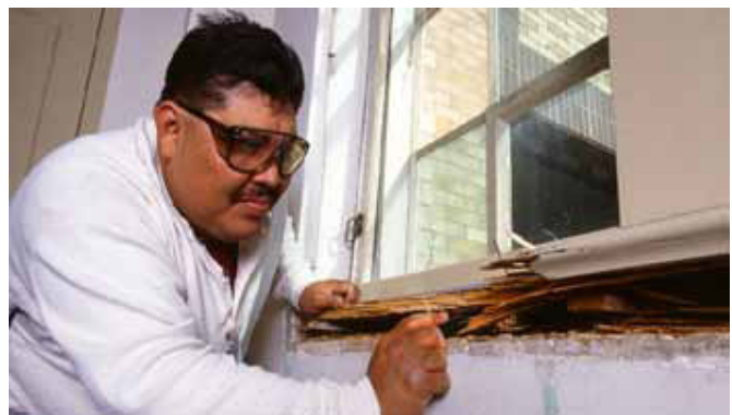
Fig. 9. Fuertes daños por la alimentación de las termitas puede causar ampollas en la pintura. 4
