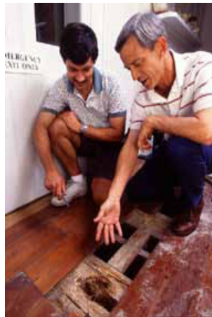
Fig. 10. Las termitas subterráneas pueden destruir vigas de madera sólidas. 4
