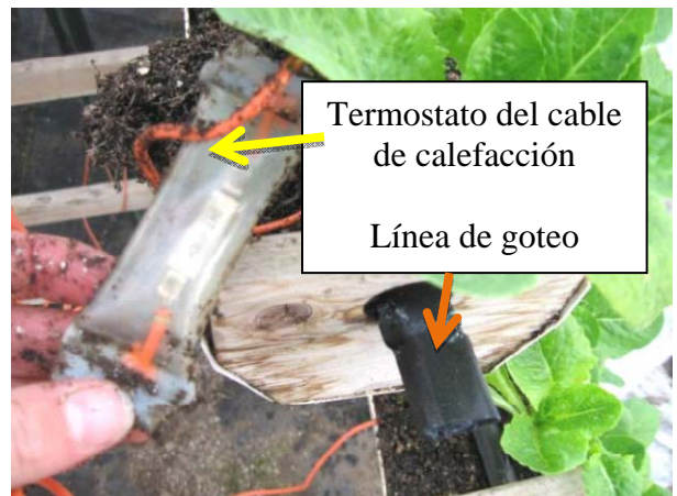
Figura 5. El cable de calefacción usado en los canalones de PVC.
